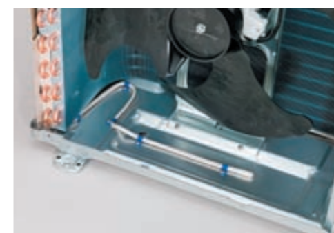
Die Abtauheizung (weißes Kabel) verhindert das Einfrieren des Kondensats im Winter.
